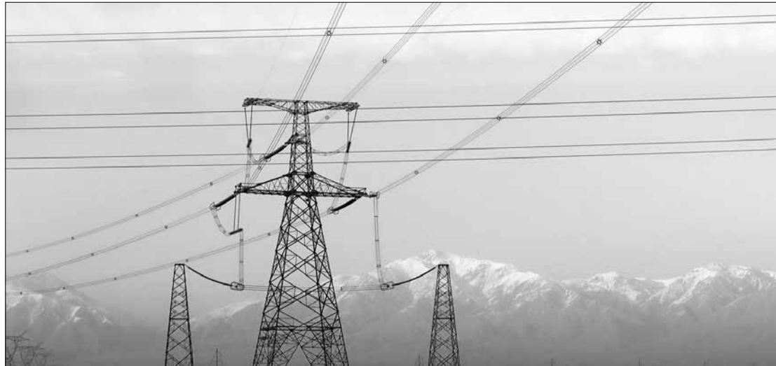
Електричество, генерирано в Синдзян-уйгурския автономния регион, се пренася чрез далекопроводи през пустини, планини и реки до мегаполиса Чунцин на разстояние 2260 км
